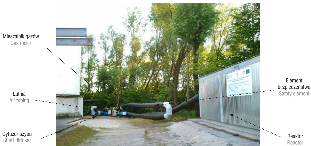
Instalacja badawcza w skali półtechnicznej o symbolu IUMK-1000 Semi-technical scale research installation IUMK-1000
