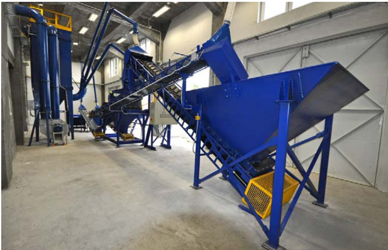
Instalacja demonstracyjna do produkcji kruszyw z odpadów powęglowych z płuczek ciecży ciężkich A demonstration system for production of aggregates from coal mining waste from heavy liquid coal washers
